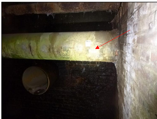
Foto 19: Ter hoogte van waterrad: Buis (Bron 1) (Asbesthoudend)
