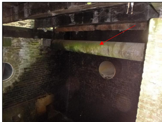
Foto 20: Ter hoogte van waterrad: Buis (Bron 1) (Asbesthoudend)
