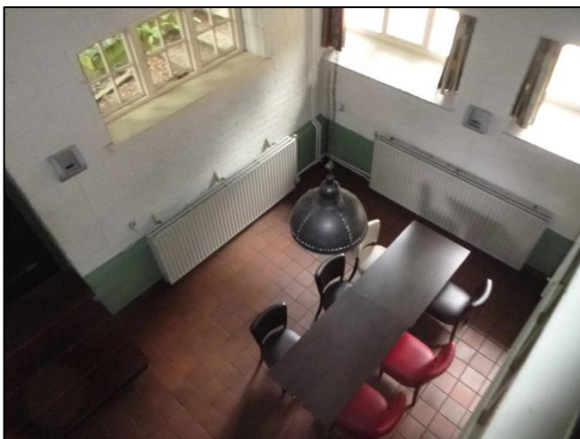
Foto 41: Zaal: Radiatoren (Niet asbestverdacht)
