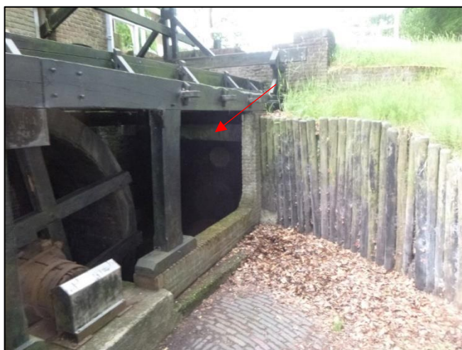
Foto 21: Ter hoogte van waterrad: Buis (Bron 1) (Asbesthoudend)
