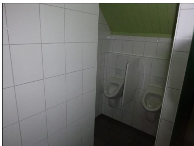
Foto 36: Toiletten, wanden: Tegellijm (Ontoegankelijk)
