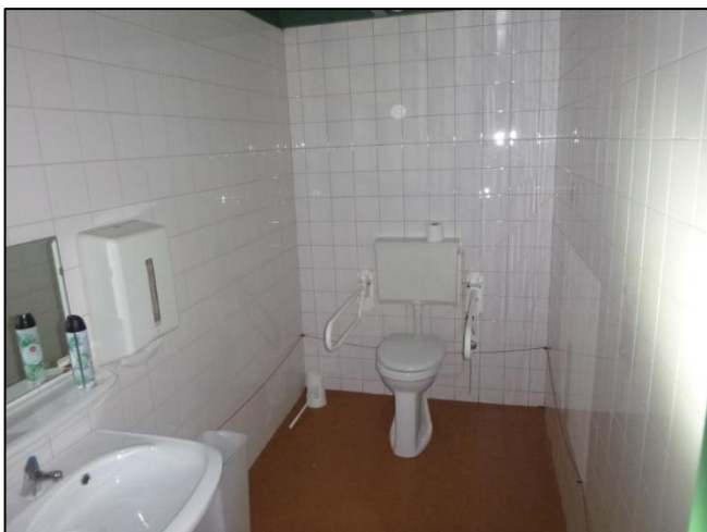
Foto 29: Toilet, wanden: Tegellijm (Ontoegankelijk)
