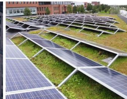
PV panelen op dak
