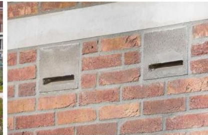
Kasten voor vleermuizen in de gevel
